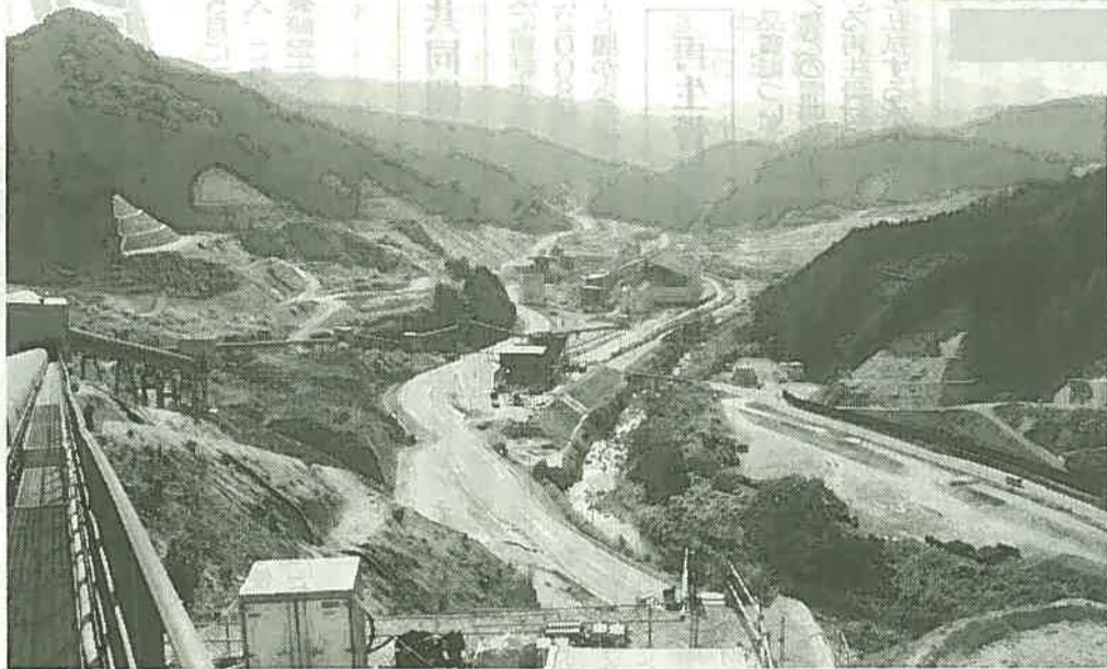
伊良原ダム(福岡県行橋市)の骨材製造設備
